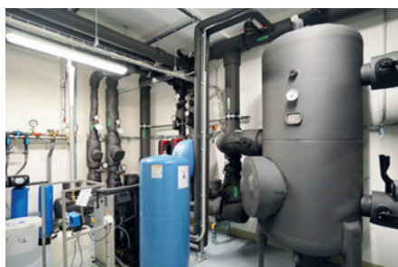
Rozvody tepla a chladu
